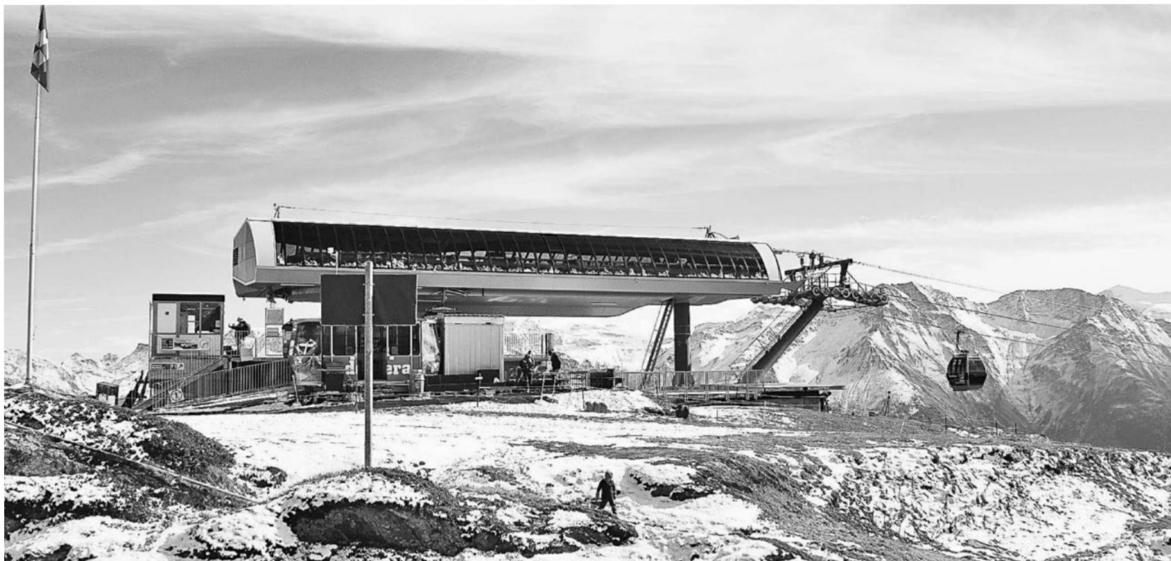
Bergstation Moosfluh. Aufgrund geologischer Senkungen hat sich unter dem Betonfundament ein Hohlraum gebildet.
